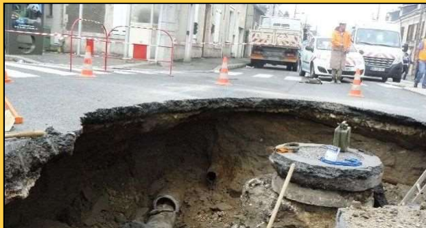
Effondrement d'une rue (La République du Centre)
